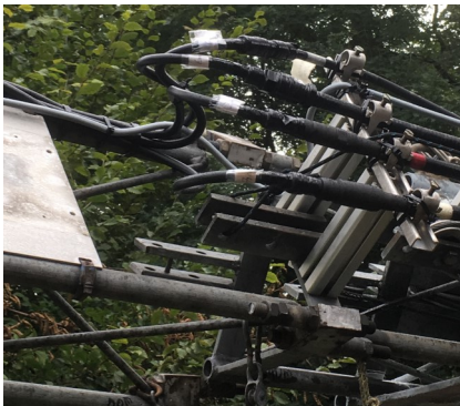
Oben: Detail Kabelkopf oben am Masten mit den Trennstellen
